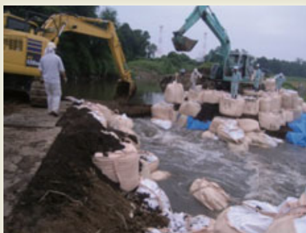
西仁連川決壊現場。大きく決壊した箇所に大型土のうを設置して止水作業。
