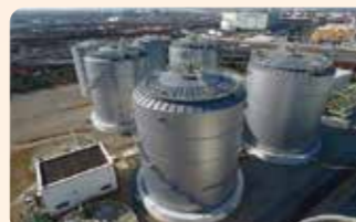
鋼板製消化タンク
